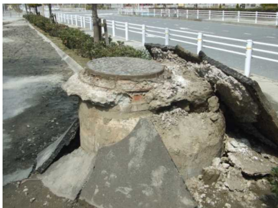
マンホールの異常隆起(浦安市)
