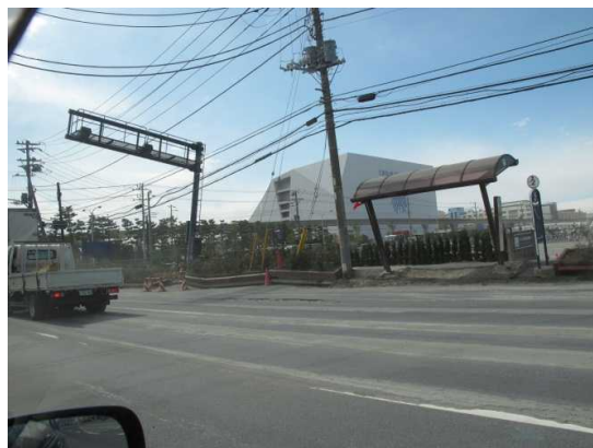
傾いたバス停と電柱等(浦安市)
