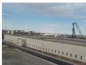
③水処理第1系列全景
