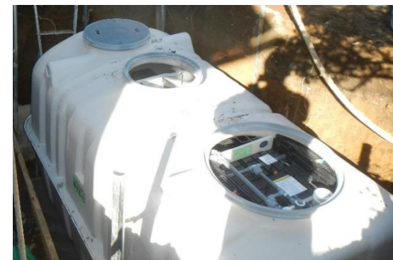
合併処理浄化槽
