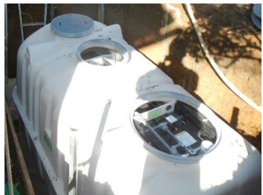
合併処理浄化槽
